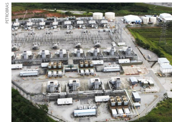
| Usina Termelétrica Termomacaé (Mário Lago)
