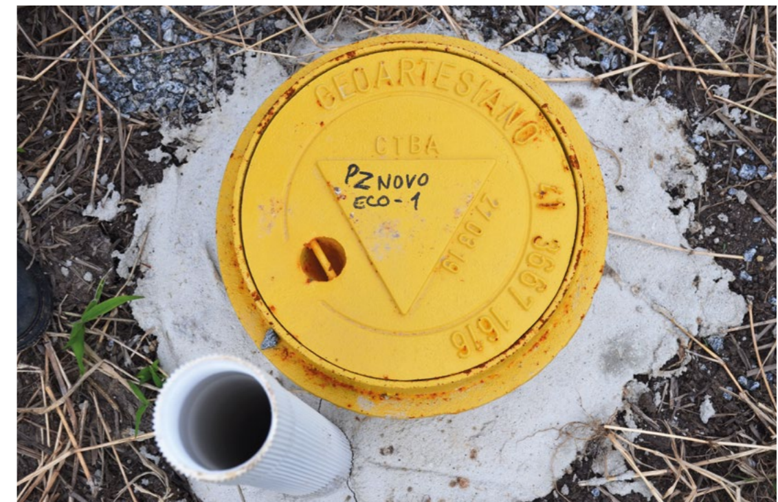
| Poço de monitoramento
