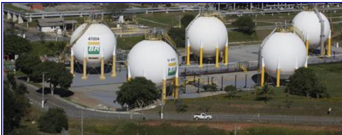
FIGURA 7.4.2-1: UNIDADE DE TRATAMENTO DE GÁS DE CABIÚNAS FONTE: PETROBRAS, 2017.
