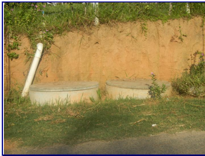
Foto 7.4.4-3: CONJUNTO FOSSA-SUMIDOURO PARA TRATAMENTO INDIVIDUAL DE ESGOTOS DOMÉSTICOS FONTE: ECOLOGUS, 2018.
